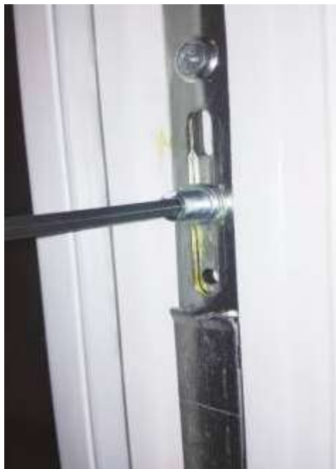
Skrzydło okna rozszczelnione - klucz imbusowy
